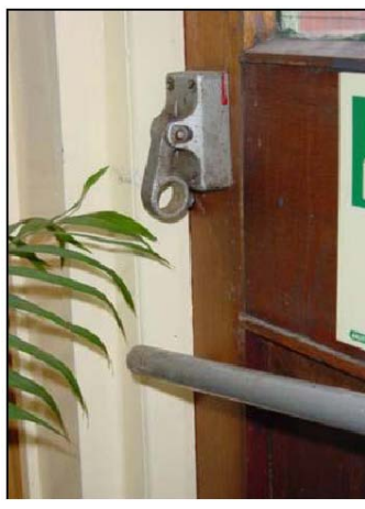
Fire door handle broken
