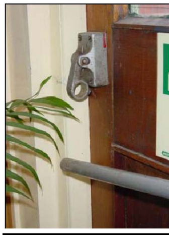
Fire door handle broken
